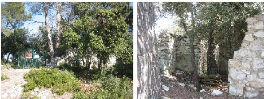
Puits de mine condamnés, ouvrages ruinés
