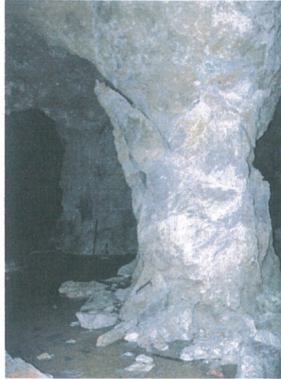
Photo n°1 - Rupture de pilier : Guide technique "cavités souterraines"
