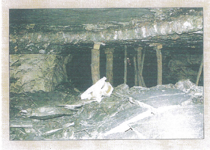
Photo n°2 - Rupture de toit : Guide technique "cavités souterraines"
